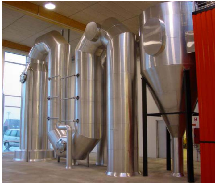
Kjel med etterfølgende multisyklon og røykgasskondensering (foto Hollensen Energy AS)
