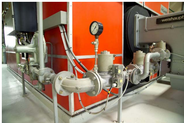
Gassinstallasjon på kjel (foto SWECO Grøner AS)
