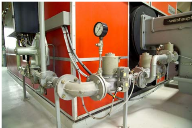
Gassinstallasjon på kjel (foto SWECO Grøner AS)
