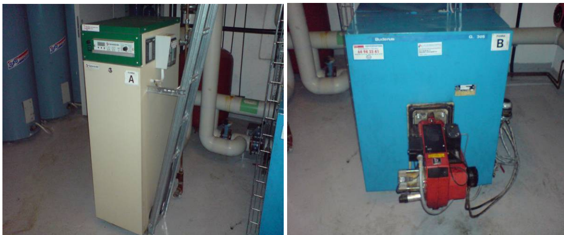
Elektrisk kjel og oljekjel på Jaer Skole (foto: SWECO Grøner AS)
