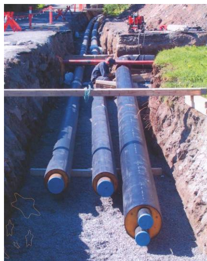
Enkle stålrør og twin rør, foto: Enova SF
