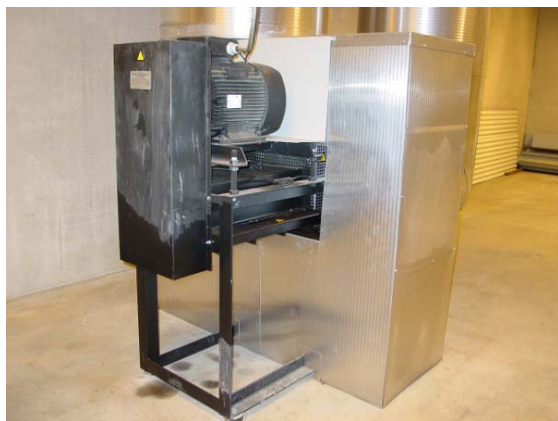
Røykgassvifte (foto SWECO Grøner AS)
