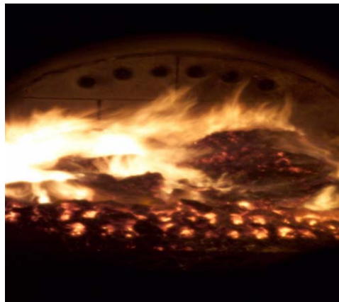
Brennkammer (foto SWECO Grøner AS)
