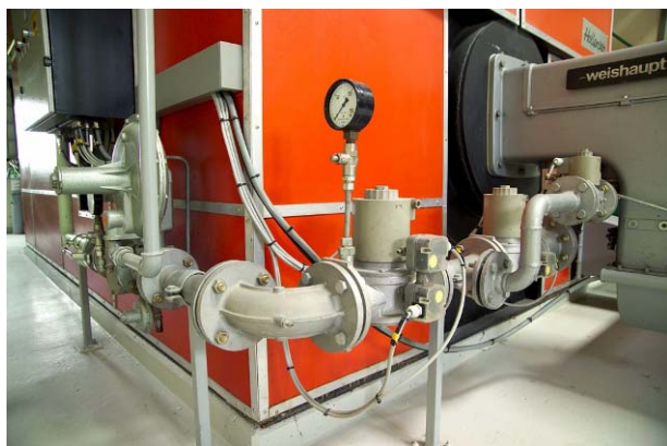
Gassinallasjon på kjel (foto SWECO Grøner AS)
