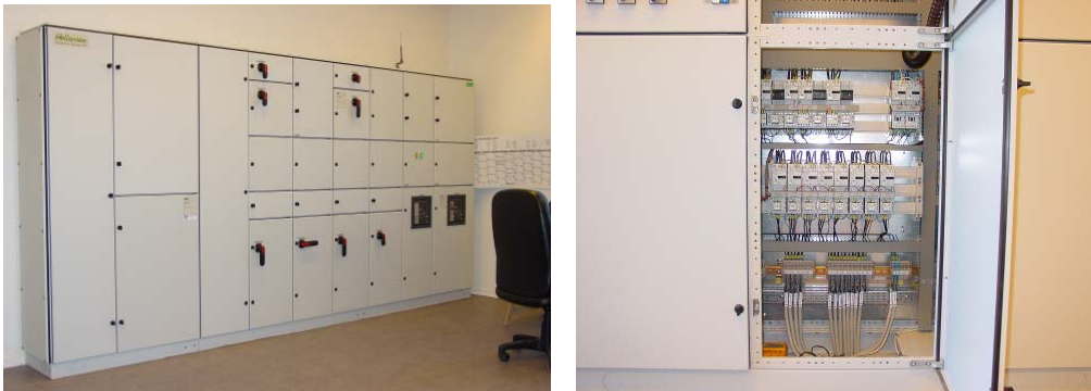
Tavleinstallasjon (foto SWECO Grøner AS)
